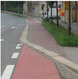
Sturzgefahr durch schrägen Bord
